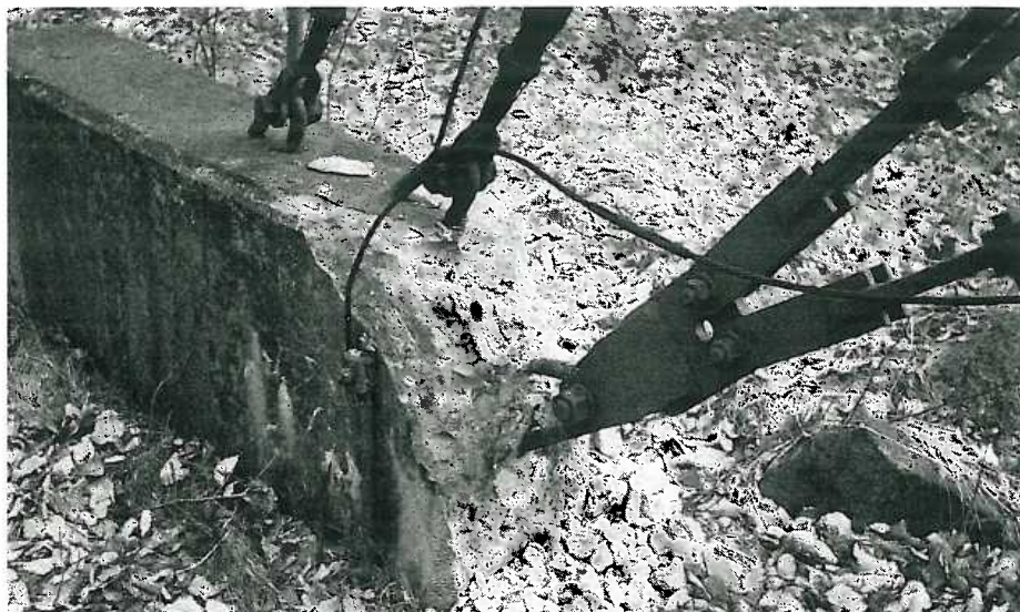
Bild 1. Skada på stagfundament.
