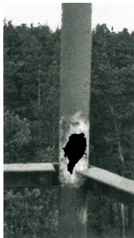
Bild 4. Korrosionsskada på mastben (PN 601, Skåne).
